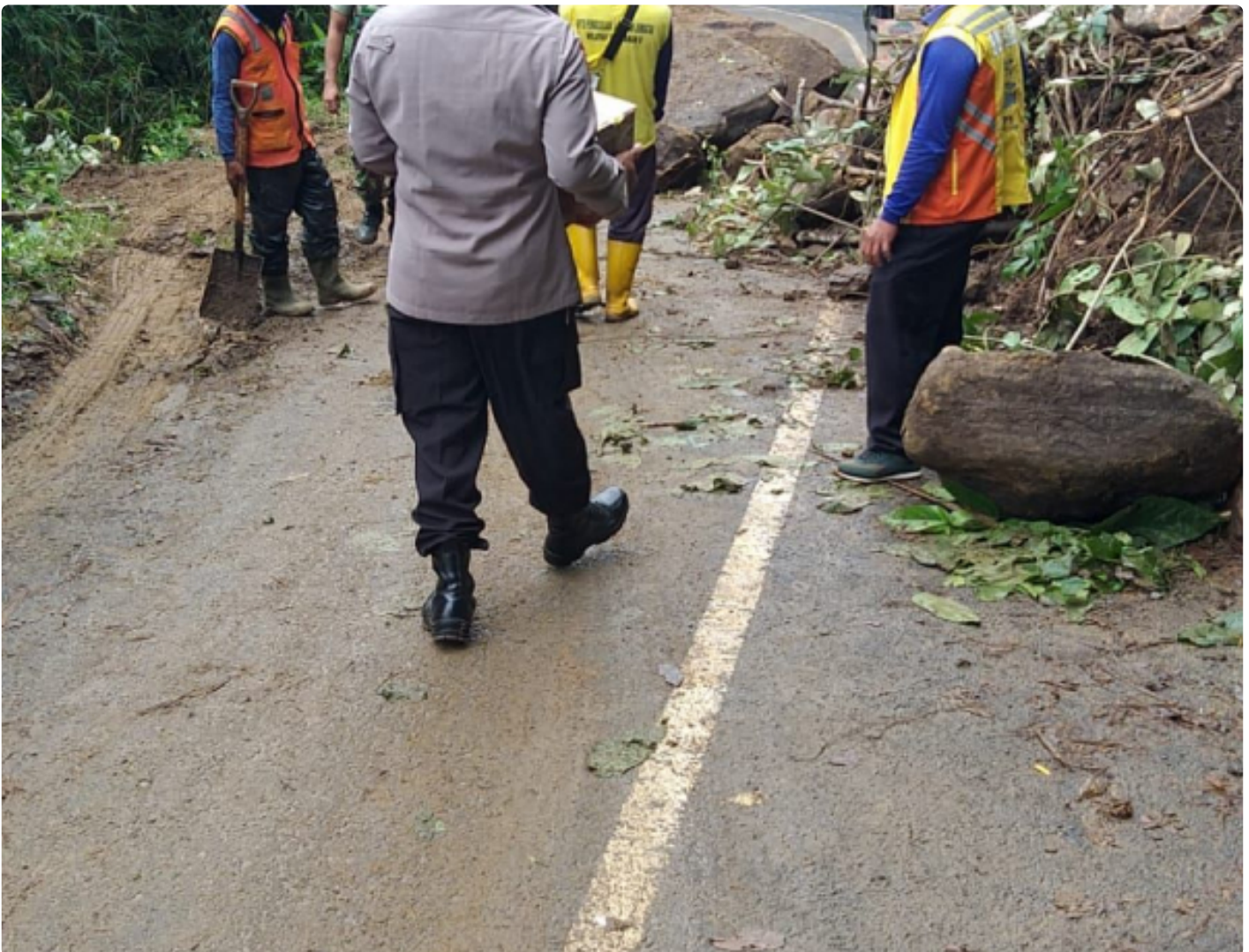
Petugas lakukan Buka Tutup Jalur Jalan Yang Terkena Longsor di Kecamatan Ciemas
